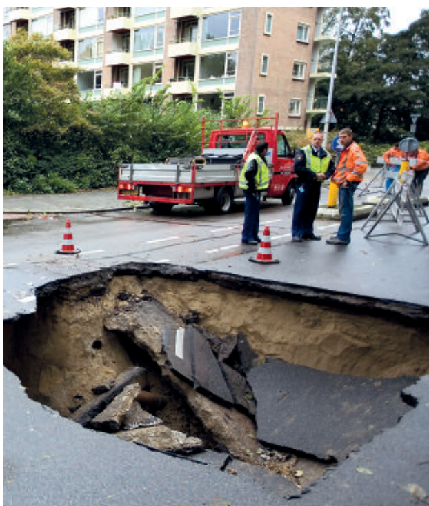
Schade ten gevolge van holle ruimten/instabiele zones
